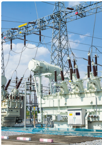
Nguồn điện trung thế và hạ thế
